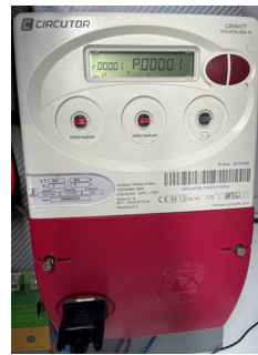
Figura 8 Conexión de cable DB9 en contador
